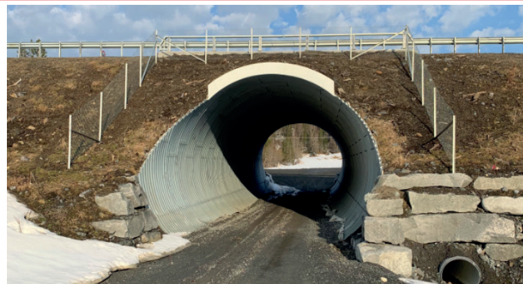
Enkel stålørskulvert for de mindre krysningene under veien. Foto: Viacon.
