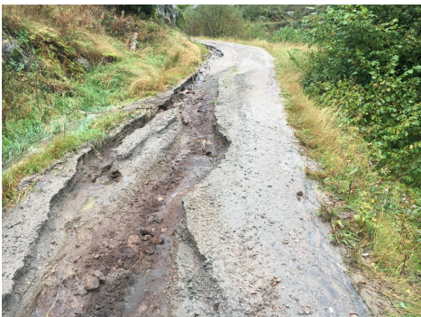
Bekken fra Stigland flommer og graver ut veien til Lauvstø, 04.10.20.
